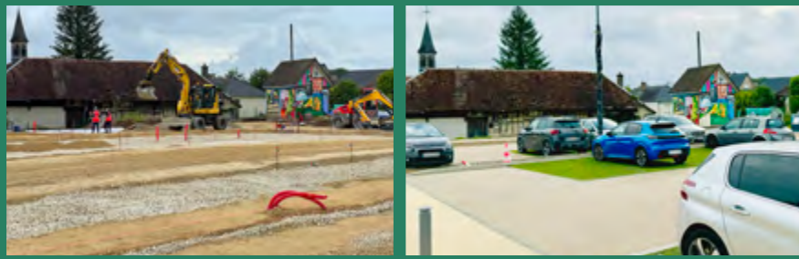
Première grande réouverture attendue de cette phase, la Place de Brombachtal bénéficie de 38 places de stationnement littéralement vertes. Celles-ci ont nécessité un temps de végétalisation de quelques semaines (avec des arrosages réguliers, pour donner un petit coup de pouce à la pousse !)
